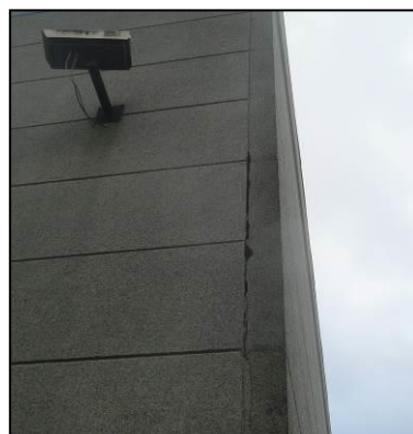
Eén van de scheuren waar vleermuizen gebruik van kunnen maken (foto Laneco)
