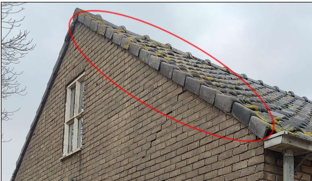
Overhangende gevelpannen en een scheur in de spouwmuur, aangeduid met de rode cirkel.
