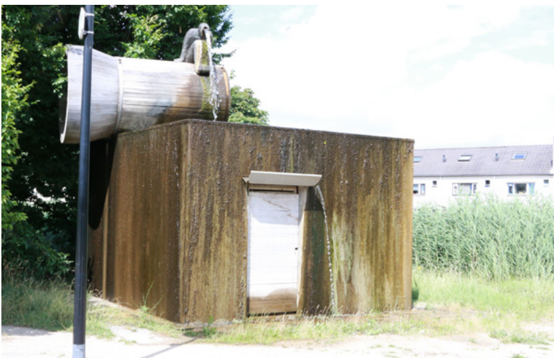
Rioolgemaal Snel en Polanen
